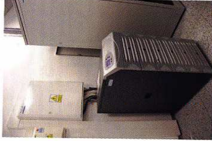
Zasilacz awaryjny 15 kV do podtrzymania pracy systemu CCTV – Biblioteka Techniczna
